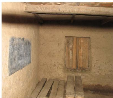
Une salle de classe : Murs lézardés, plancher dangereux, portes et fenêtres très abimées.
